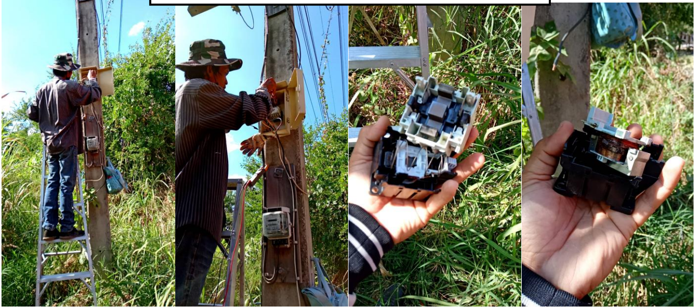
ช่างออกปฏิบัติหน้าที่ ซ่อมไฟฟ้า สถานที่คุ้มบ้านหัน หมู่ 2 บ้านไทรงาม
